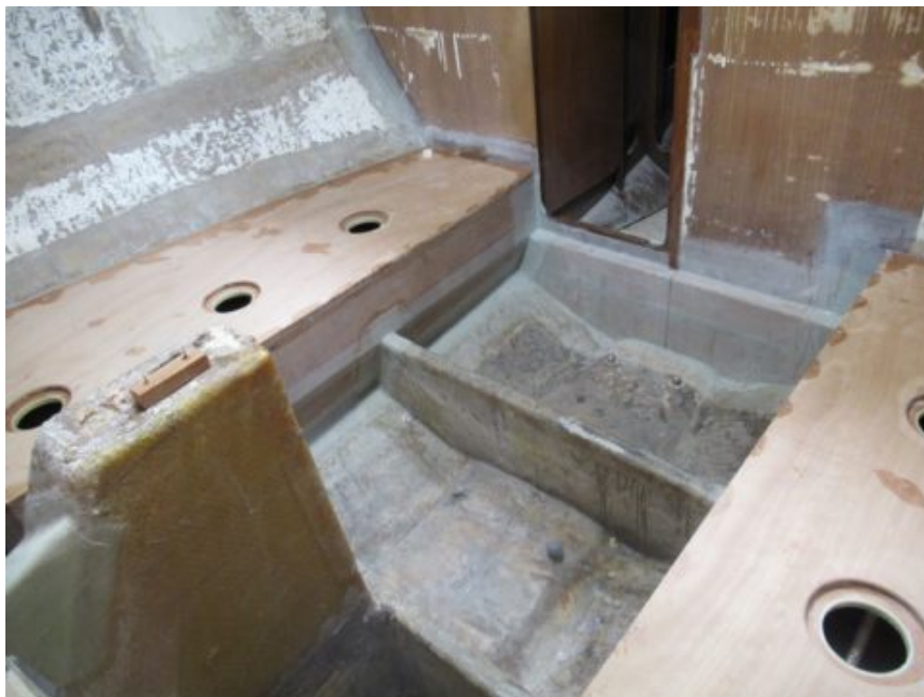
Les réservoirs montés
